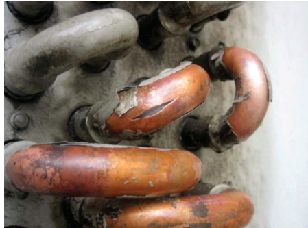
Şekil 2.28 Donma sonucu kuru soğutucu borularında meydana gelen tipik bir hasar (Kaynak: Friterm)
